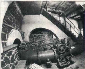
Nur die wenigsten Hallenser kennen das Innenleben des Wasserspeichers. Die riesige Schieber-Vorrichtung befindet sich im Kellergewölbe.
